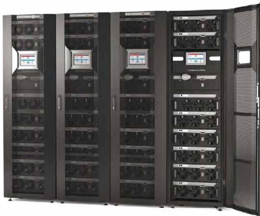
Силовой шкаф (1+7 x силовых модулей) x 4
